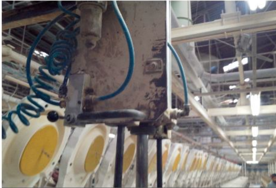
Figura 1.2 - Disposição real das louças sanitárias na bancada de sistema de colagem.
